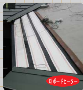
ルーフィングの上にCFボードヒーターを敷設。
