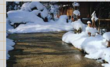
▲ CFボードヒーターを埋設した250mmの石面もきれいに消雪 (山形県)
