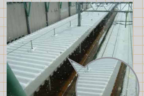
▲降雪中でもCFボードヒーター設置箇所はほとんど積雪がない
