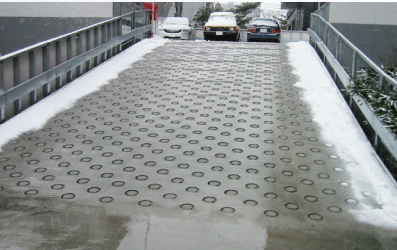
《マンション出入口のスロープ》 ▲スロープ部分にCFボードヒーターを埋設(新潟県)
